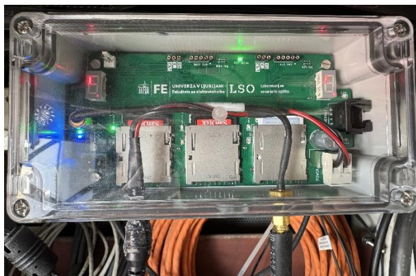
Slika 6: Namestitev zapisovalnika GNSS podatkov v ohišje IP65 znotraj neogrevane tehnične kabine nad poveljniškim mostom Laure Bassi. Spodaj sta vidna priključka za zunanje napajanje in anteno GNSS.
